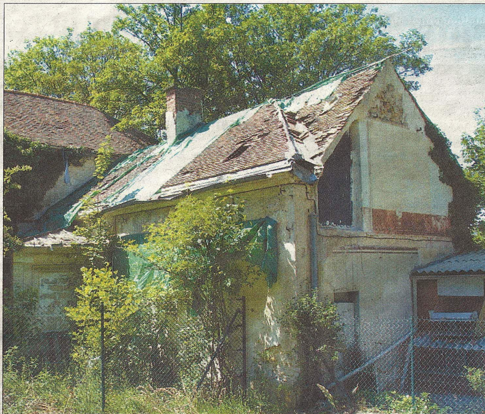
Demeure du XVIII e siècle, le domaine de Bon Repos tombe en ruines après avoir dû faire face à la tempête de 1999 et à plusieurs incendies.
